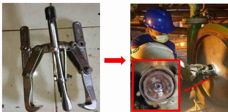
Gambar 4. Kerusakan exhaust fan
